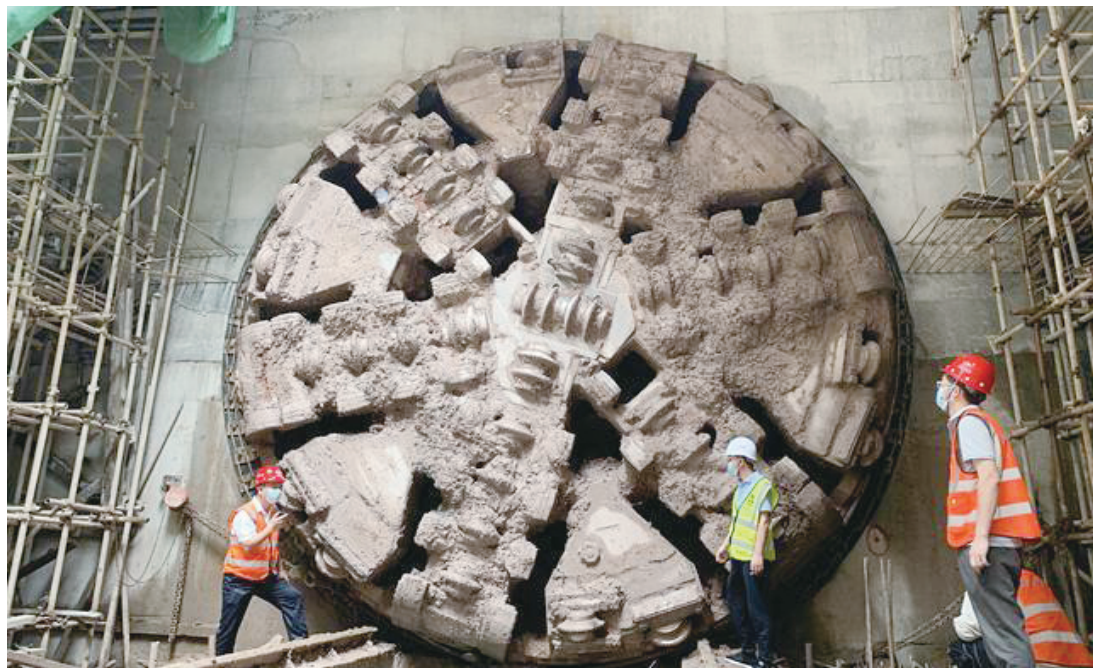
广州中心城区地下综合管廊工程是目前国内在建以盾构法施工为主的规模最大最长的多功能地下环境隧道 (资料图片)
