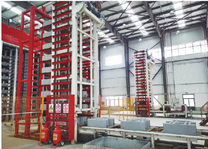
建筑垃圾资源化利用企业制砖生产线
