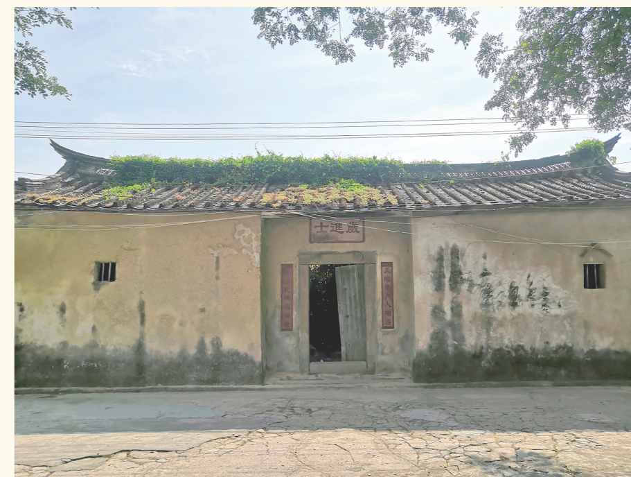
墙体发霉、屋顶长出植物的古建筑 刘丽莎摄
