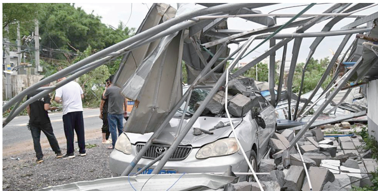
遭受龙卷风袭击的广州市白云区钟落潭镇光明村，车辆被倒塌的建筑物结构掩埋。（图源：新华社）
