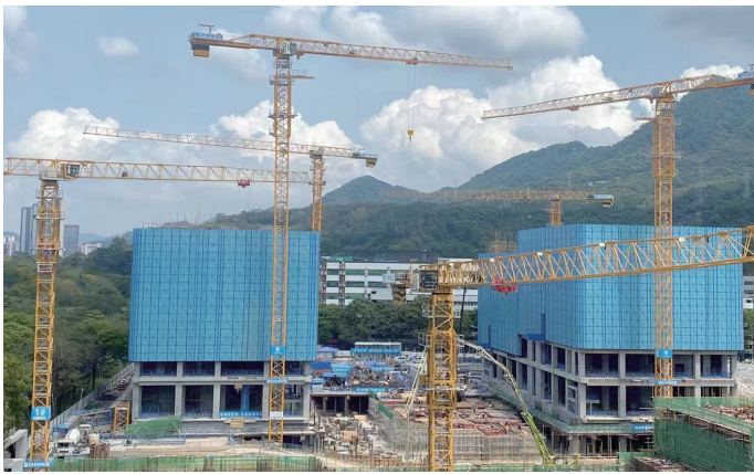
深圳红花岭项目，是全国首个工业上楼超高架体实施项目。
