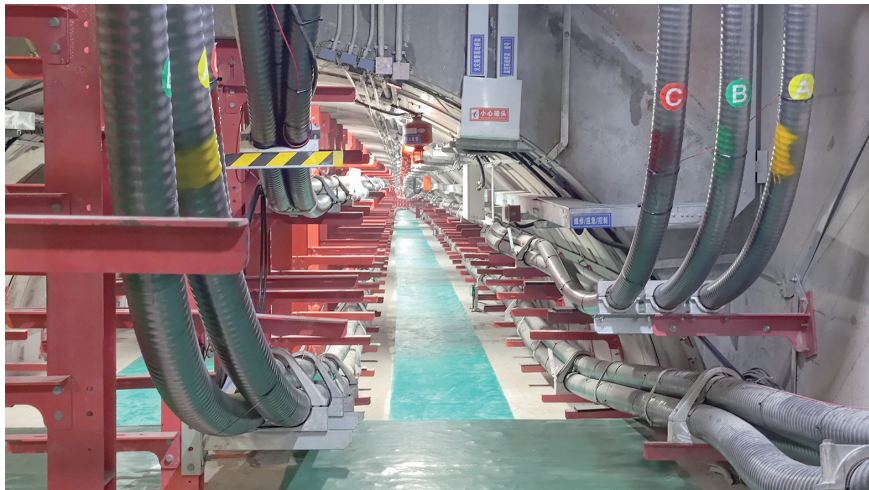
广州中心城区地下综合管廊 唐培峰摄
