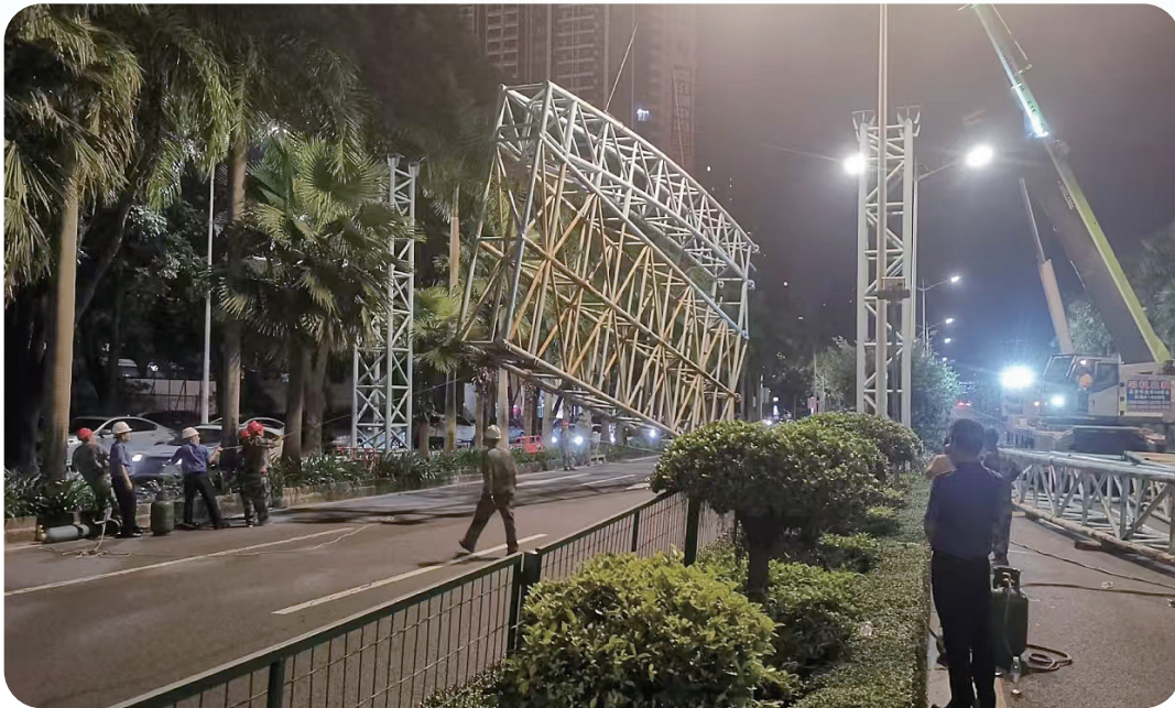
台风来临前，湛江城管拆除具有安全隐患的大型跨路龙门广告架（湛江市城管局供图）
