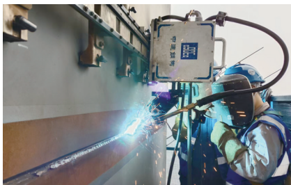
钢构焊接机器人
