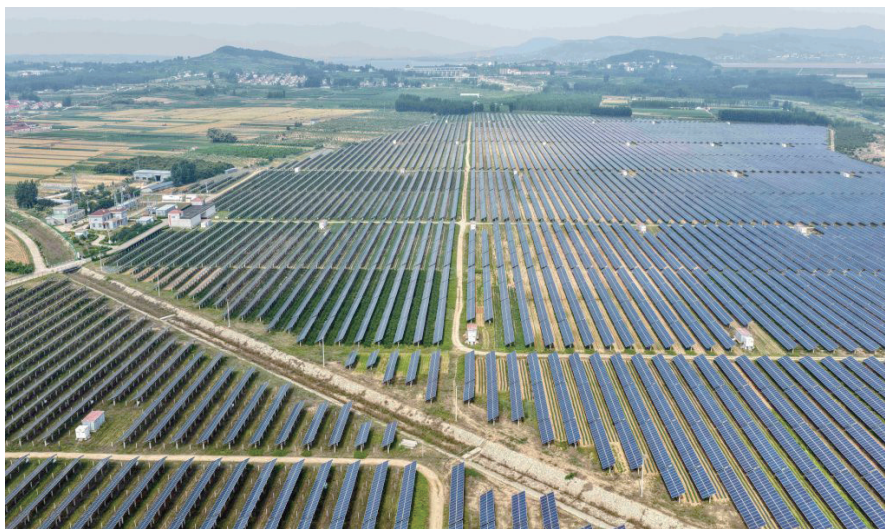
2026年6月1日拍摄的山东省临沂市沂南县岸堤镇“农光互补”49兆瓦集中式光伏电站（图源：新华社）
