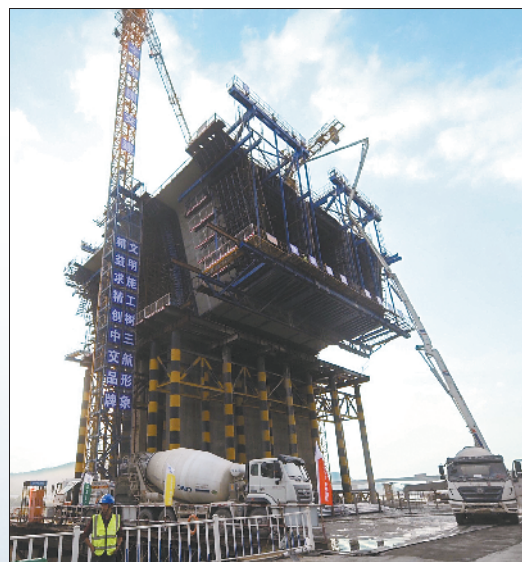
■赣深铁路剑潭东江特大桥的两个主墩已经稳稳扎在东江中，工人正在紧张施工。
