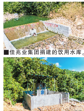
■山上安装了净水设备。
