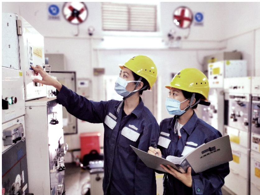
广州越秀供电局配电网自动化班班员在电房内进行数据检查核对。 许若筠/摄
