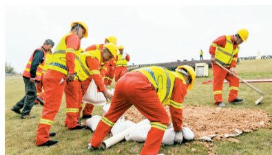
■采用“上部削坡减载,下部固脚压重”的方式进行滑坡应急处置。
