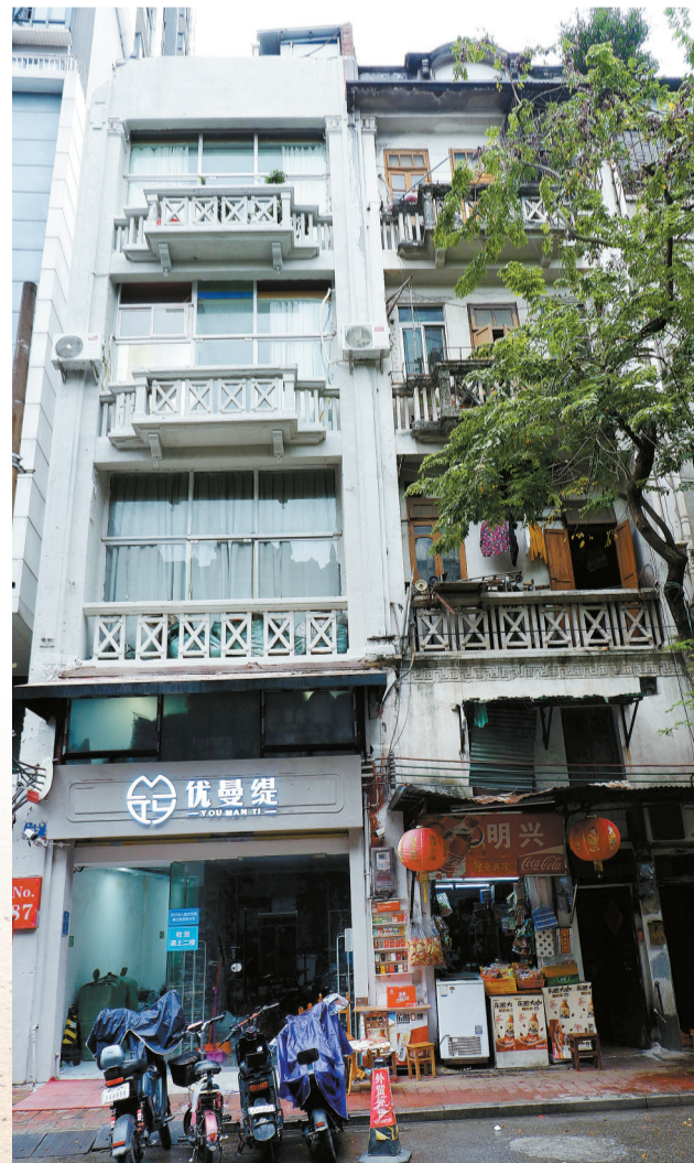
■传统风貌建筑线索十八甫路87号【上图:左边的87号本来与右边的89号外形完全一样,但被拆除了山花、飘檐及部分墙体,被刷上了红色涂料;下图(左一):业主自行整改,在红色墙上又涂上白色涂料,造成二次破坏】
