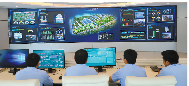
北部水厂调度中心
