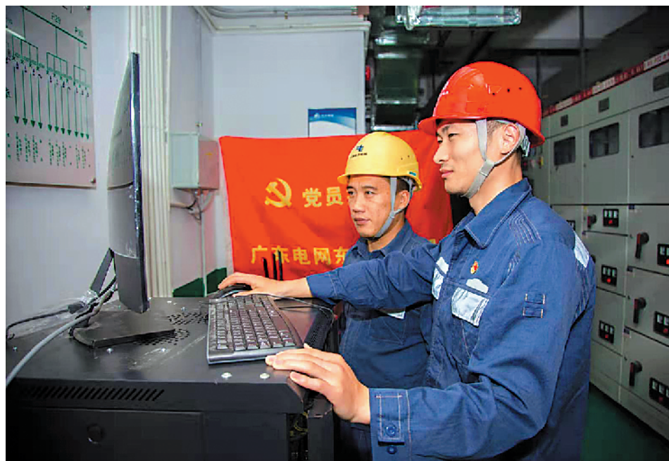
供电人员在智能配电网监控后台检查设备运行情况
