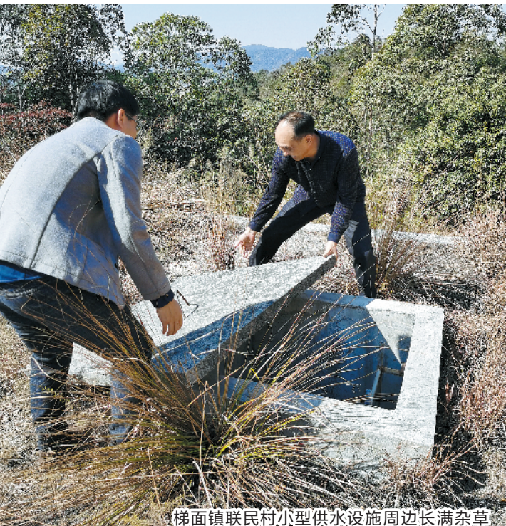
梯面镇联民村小型供水设施周边长满杂草
