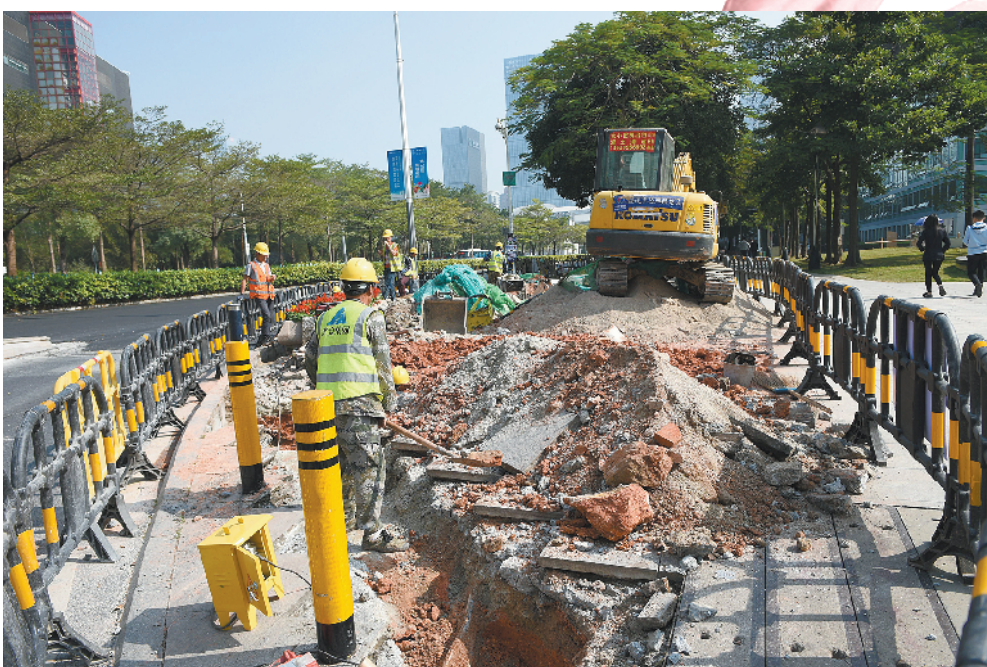
深圳仍有道路存在反复开挖现象
