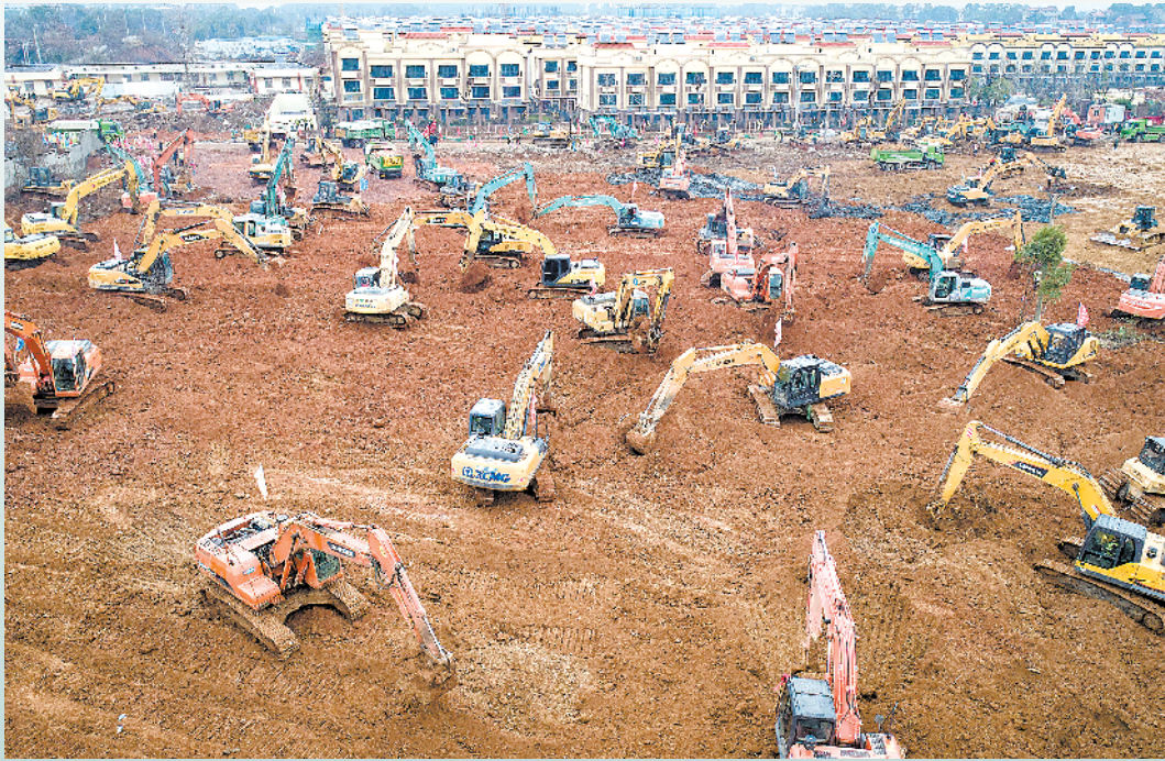
1月24日在武汉蔡甸区知音湖武汉职工疗养院附近拍摄的参照“小汤山”模式新建专门医院的施工现场(无人机照片) 新华社发
