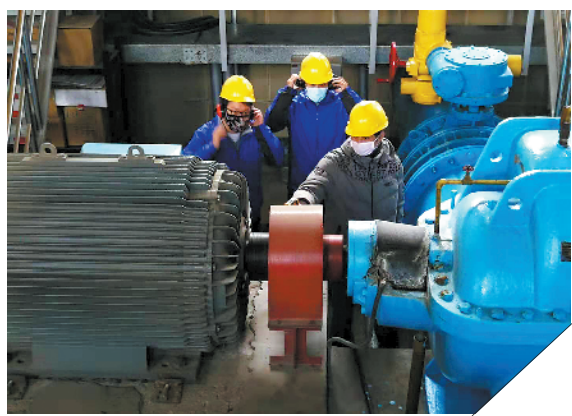
保障供水设施正常运行
