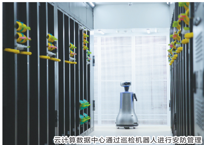
云计算数据中心通过巡检机器人进行安防管理
