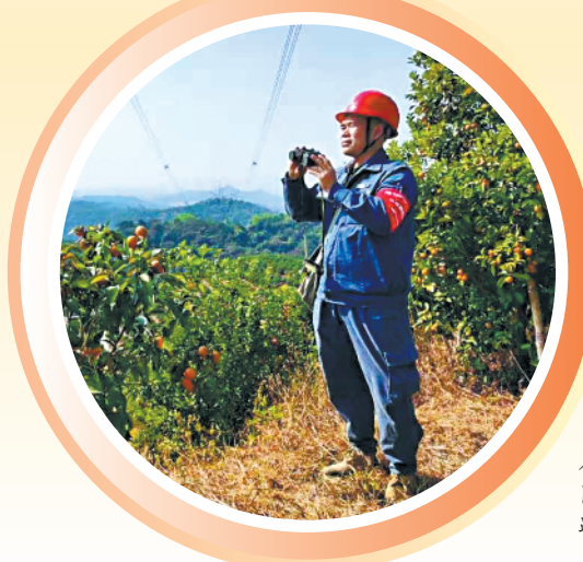
王年光正在老邓的橘子园对输电线路进行巡检 受访者供图
