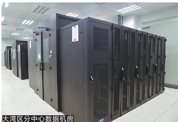
大湾区分中心数据机房
