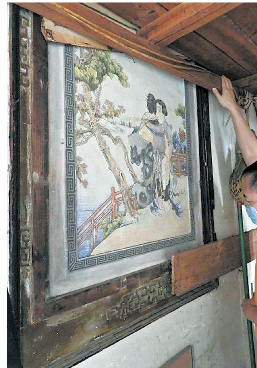
灰塑的上半部分被放杂物的阁楼完全遮挡，一块大木板被钉在灰塑精美的木质装饰框上
