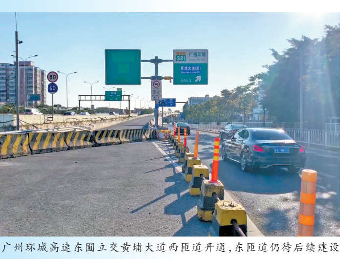
广州环城高速东圃立交黄埔大道西匝道开通,东匝道仍待后续建设
