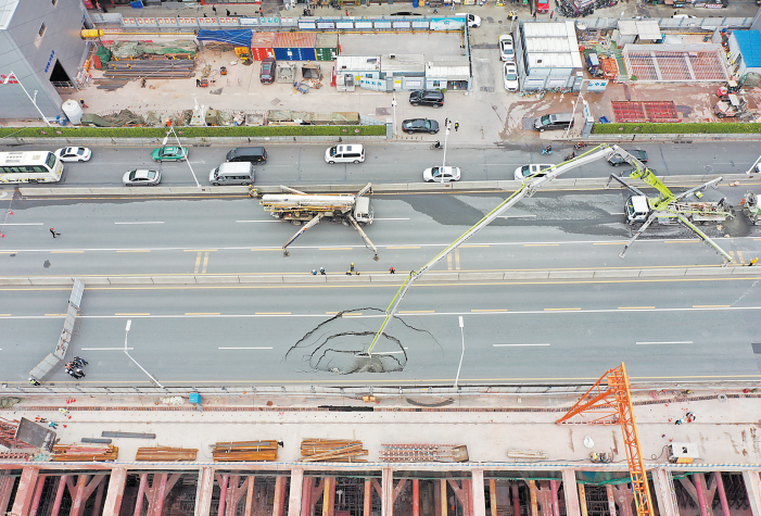
中山大道护林路跨线桥南侧路基发生路面塌陷 梁保韬 摄
