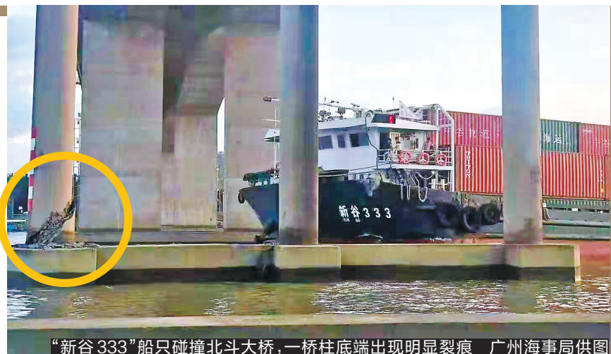
“新谷333”船只碰撞北斗大桥,一桥柱底端出现明显裂痕 广州海事局供图
