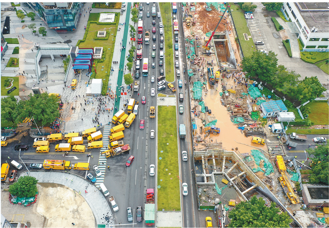
昨天16时许,抢险人员在道路两侧的地铁站出入口抢险排水 羊城晚报记者 梁倬韬 摄
