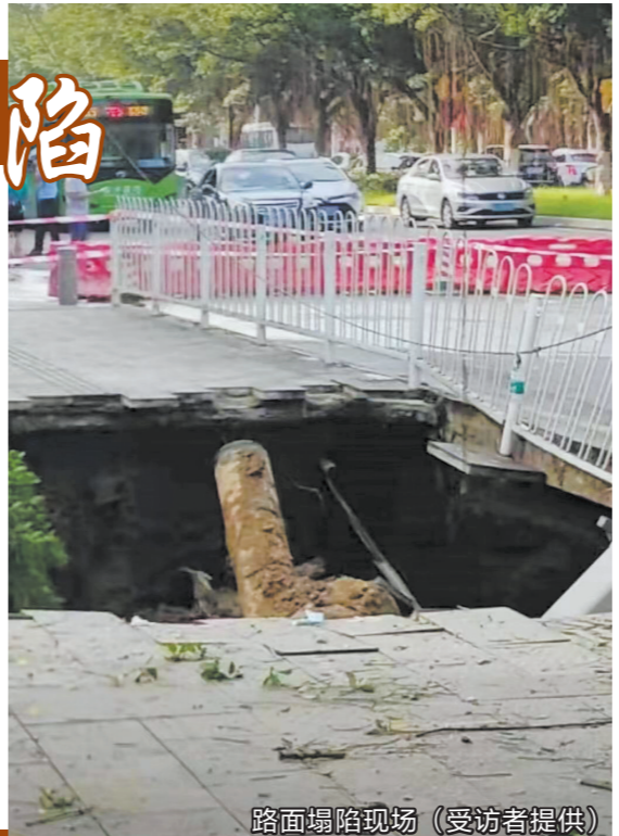
路面塌陷现场(受访者提供)
