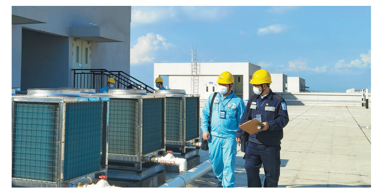
广东东莞南汇供电局工作人员到企业检查电能替代项目设备运行情况,指导保养维护设备 李洪堆/摄
