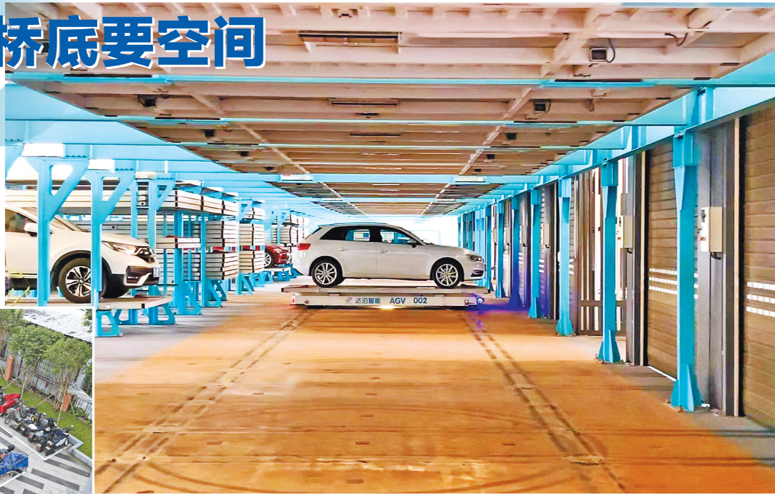
羊城晚报记者 梁伟超 实习生 刘颖颖 摄 广州环城高速奥体段桥下空间改造的智能停车场里，机器人自动把车挪入停车位
