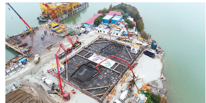
南中高速横门西特大桥主塔墩承台第三层浇筑顺利完成
