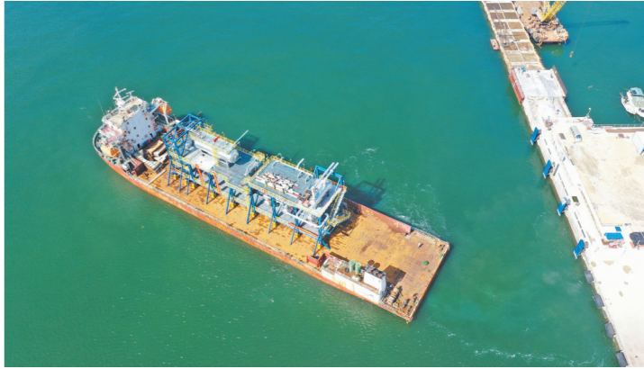
广东石化项目正在吊装施工,运输船运载大件设备靠泊产品码头
