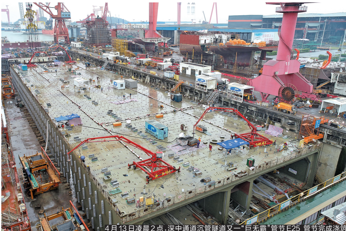
4月13日凌晨2点，深中通道沉管隧道又一“巨无霸”管节E25管节完成浇筑
