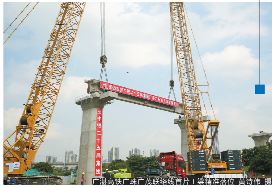
广湛高铁广珠广茂联络线首片T梁精准落位 黄诗伟 摄
