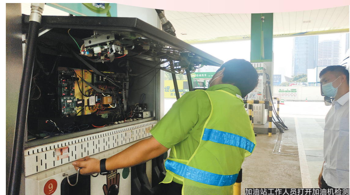
加油站工作人员打开加油机检测
