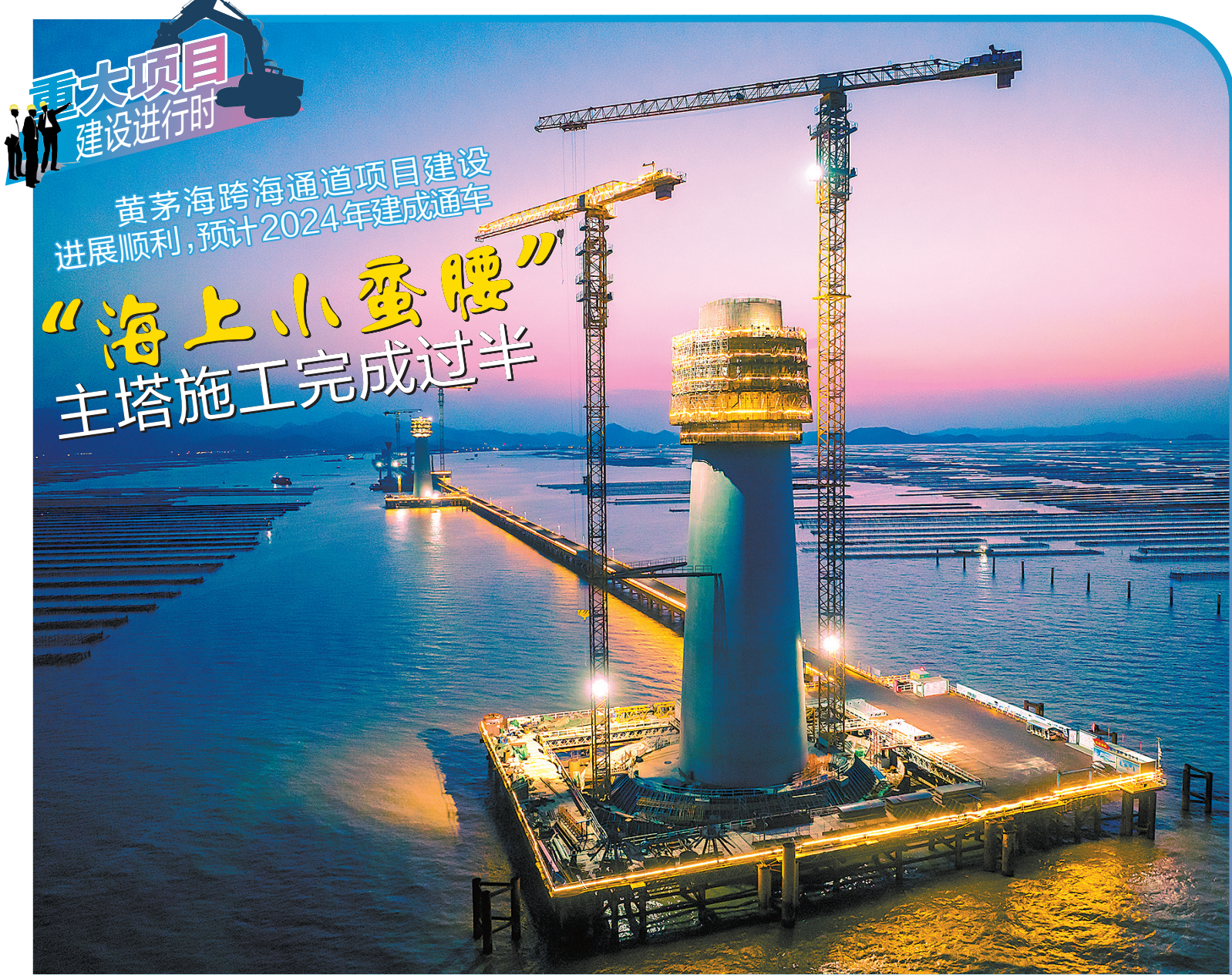
黄茅海跨海通道项目建设进展顺利,预计2024年建成通车 “海上小蛮腰”主塔施工完成过半
