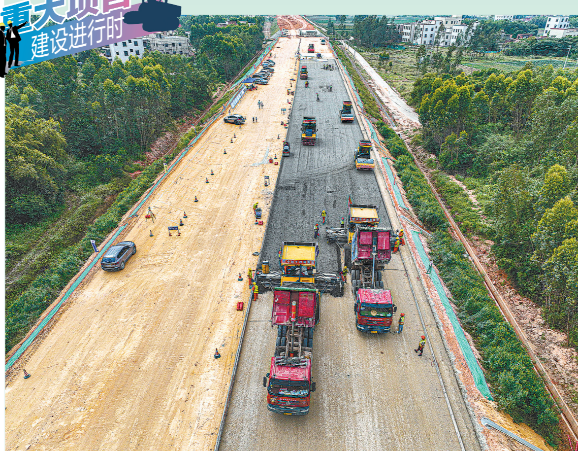
广东省重点建设项目湛江三岛大桥正式进入路面施工阶段。其中,垫层、基层、沥青路面将全部使用3D数字摊铺技术
