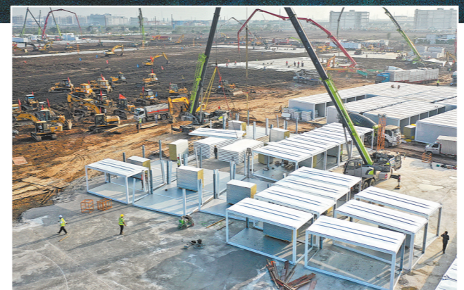
17日下午,广州南沙健康驿站建设现场,陆续有板房开始组装 羊城晚报记者 汤铭明 摄
