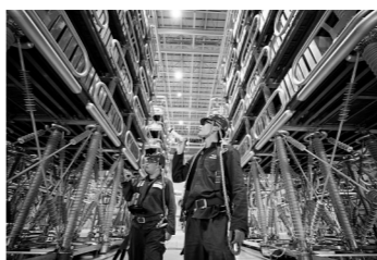
南方电网广东东莞供电局的工程建设人员在开展工程换流站设备的验收工作 受访者供图
