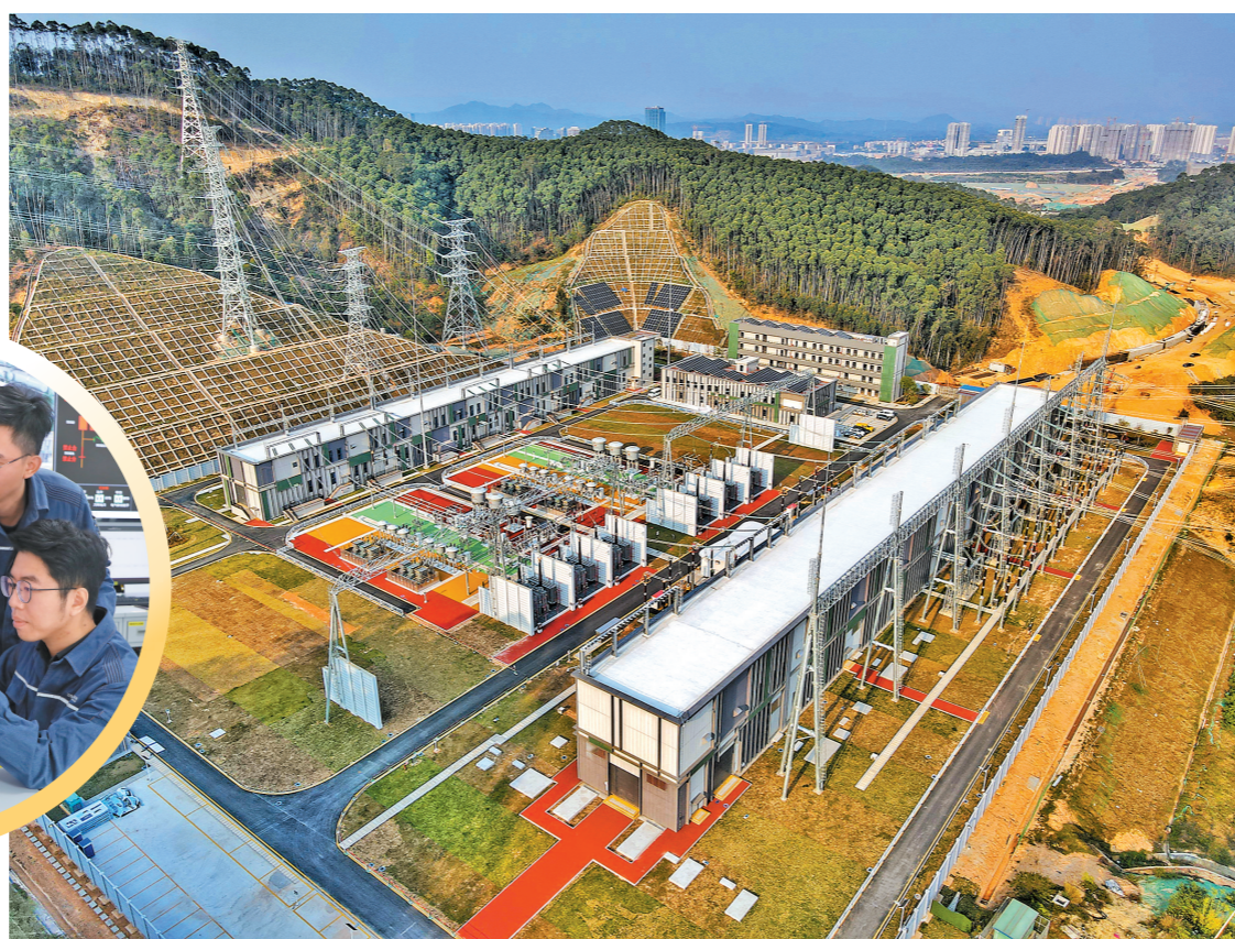
500千伏科北变电站坐落在黄埔区新龙镇深山之中 刘若颖 摄
