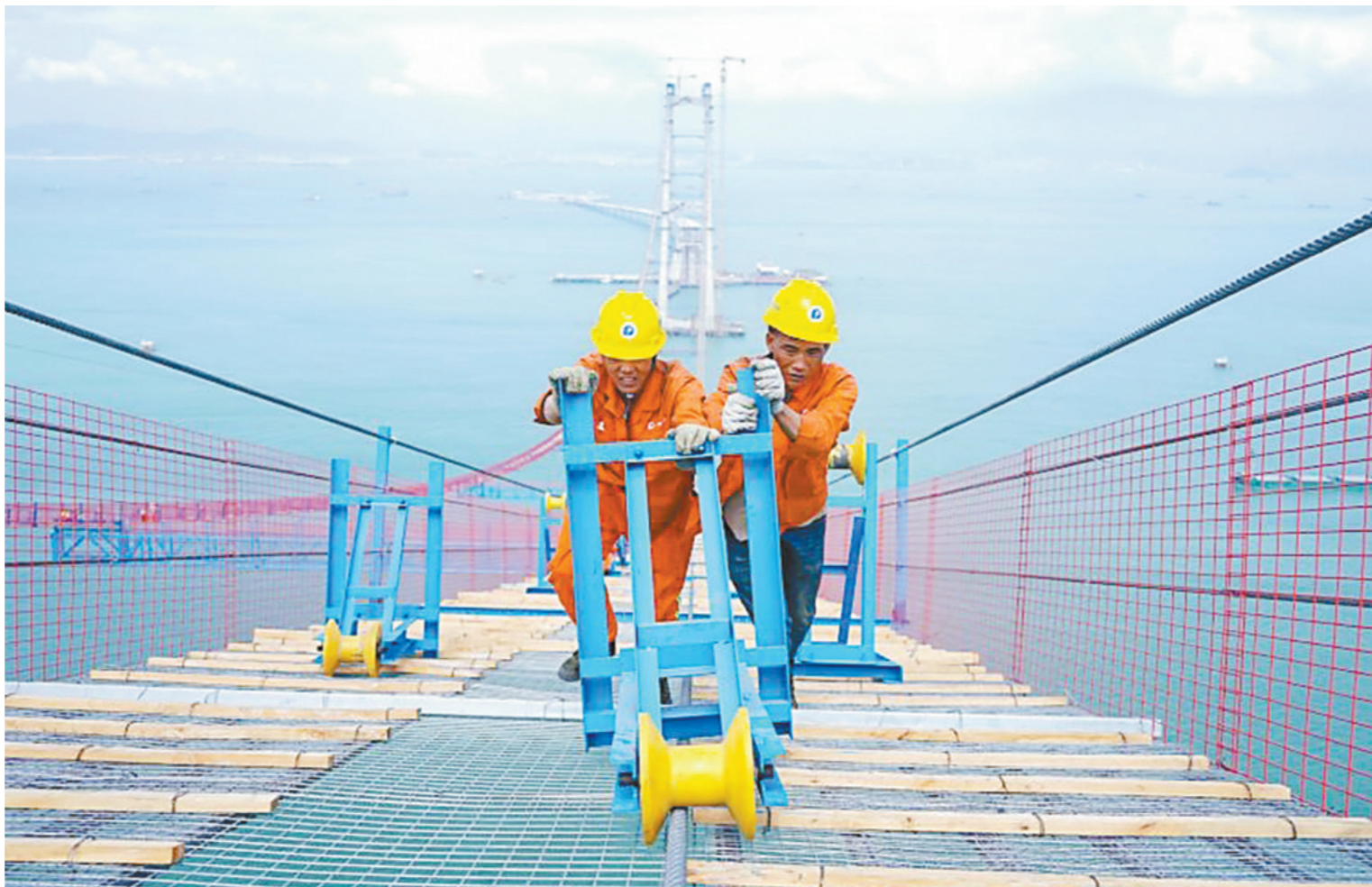
踏上中国式现代化新征程,广东奋力把“施工图”变为“实景图”。图为深中通道伶仃洋大桥施工现场 通讯员供图
