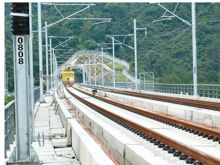
梅龙高铁接触网工程冷滑试验正式开启 张涛涛 摄
