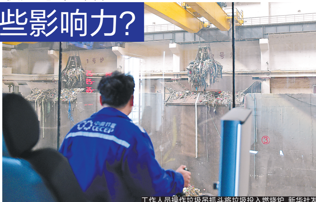
工作人员操作垃圾吊斗将垃圾投入焚烧炉 新华社发
