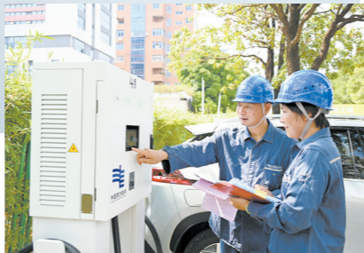
南方电网广东电网佛山南海供电局工作人员正在检查验收充电桩设备
