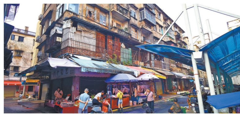
旧的集群街2号楼被鉴定为D级危房 受访者供图
