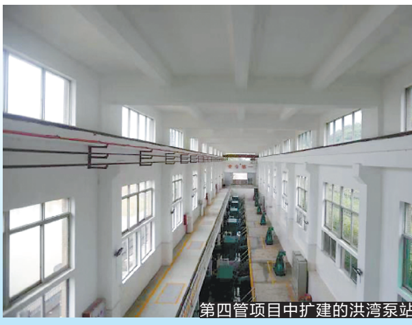
第四管项目中扩建的洪湾泵站
