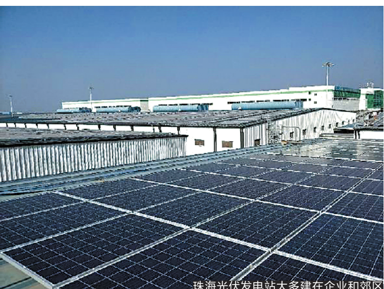
珠海光伏发电站大多建在企业及郊区
