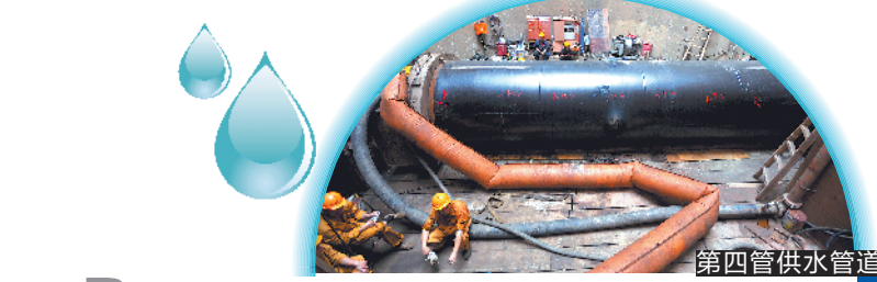
第四管供水管道
