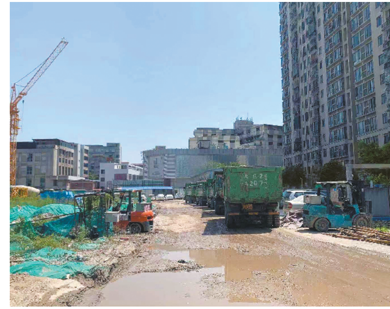
工地擅自消纳渣土
