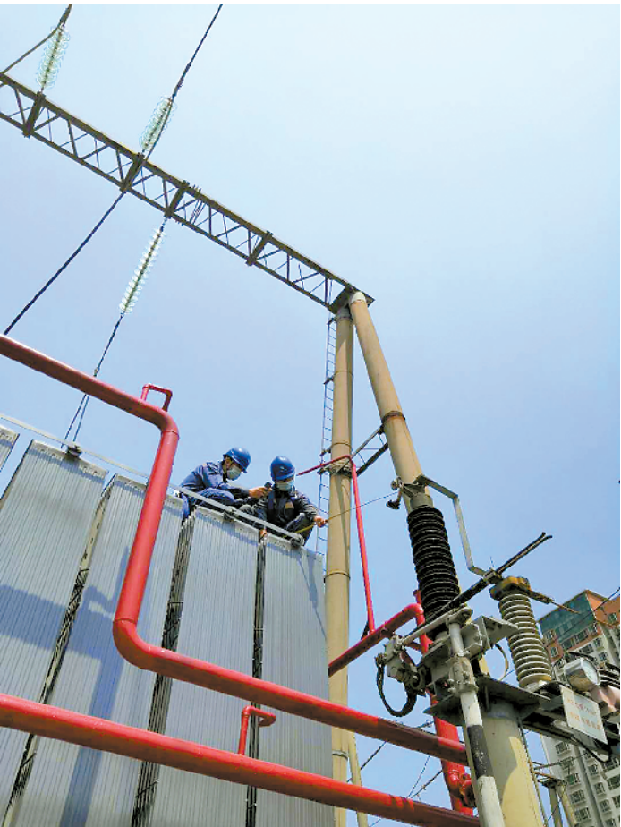
东莞供电局变电管理二所工作人员对变电站主变冷却系统工程验收 杜业 摄
