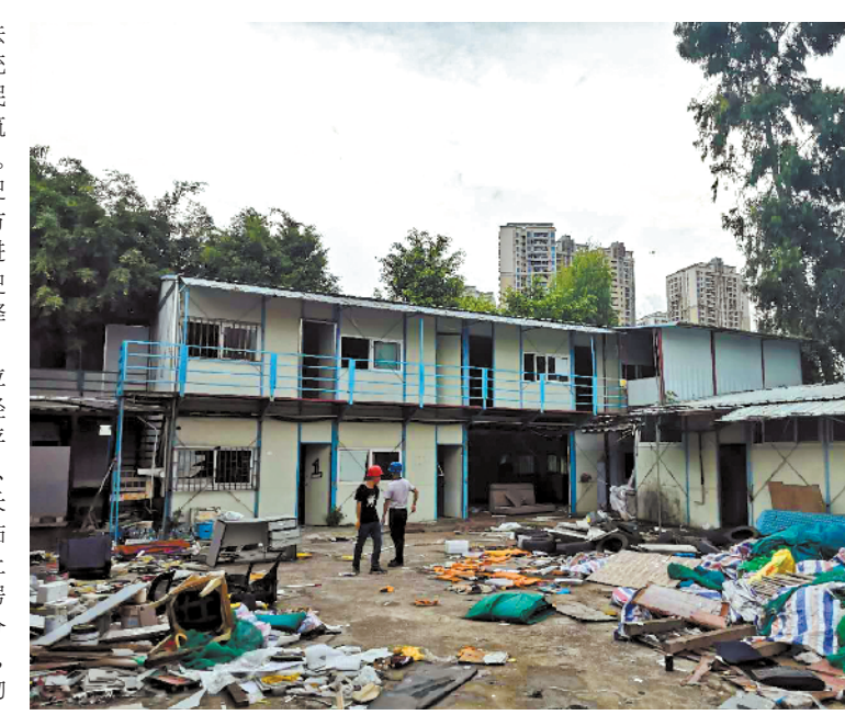
边对剩余历史遗留板房的居住人员做劝离工作，经前期多方工作和多次现场劝导，剩余3处板房的居住人员于近日全部撤离。9月10日，横岗街道执法队按照前期制定的清拆方案，出动40余人，两台钩机，对该地块上的最后3处历史遗留板房进行了彻底拆除，并清理了周边乱堆放物品。
